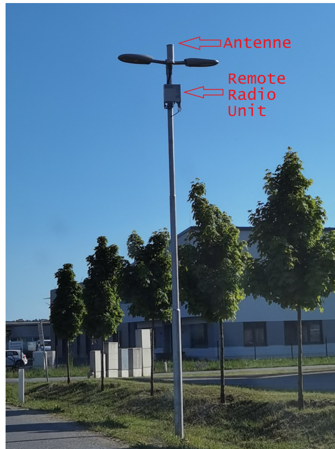
Abbildung 4.3: 5G Sendestation im Wirtschaftspark A5 Miselbach-Wilfersdorf. Quelle: Eigene Aufnahme (15.05.2022)
